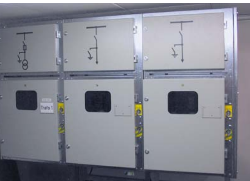
EMN Schaltanlage A89 3-feldige Anordnung: Trafo-Kabel-Kabel
